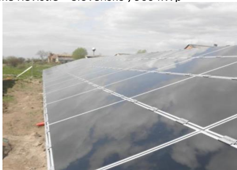
FVE Velké Revištie – Slovensko , 900 kWp
