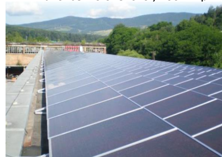
FVE Prakovce – Slovensko , 100 kWp
