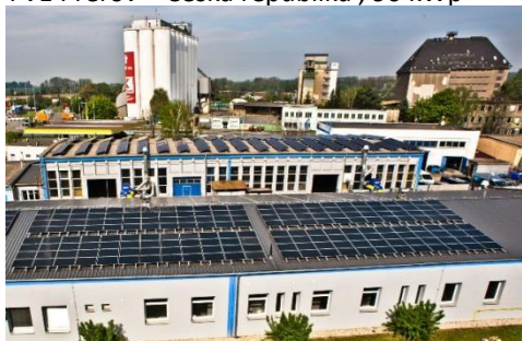
FVE Přerov – Česká republika , 90 kWp
