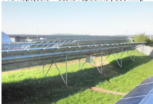
FVE Napajedla – Česká republika , 800 kWp
