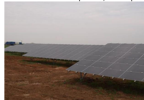
FVE Rakovník – Česká republika , 500 kWp
